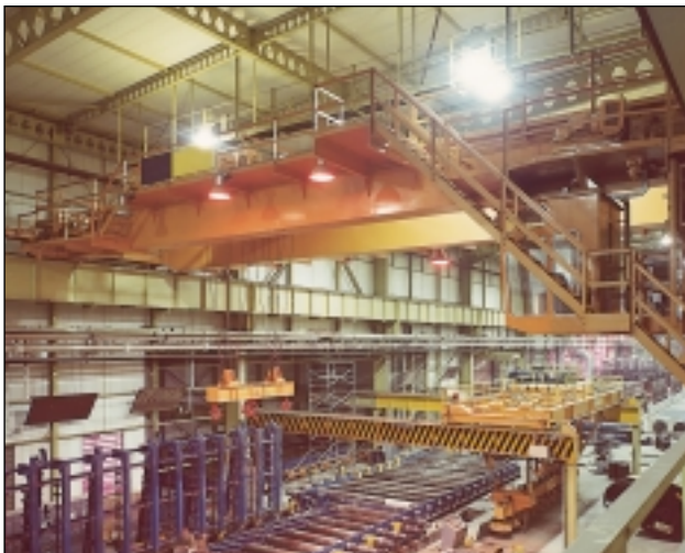
Laminoirs. Accouplements montés sur pont roulant de 35 tonnes et sur les mécanismes de commande des tables à rouleaux.
