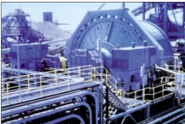
Broyeurs. Accouplements montés entre moteurs électriques, réducteur et broyeur.
