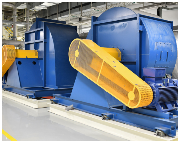
Acoplamiento colocado entre el motor eléctrico de frecuencia variable y la correa del ventilador
